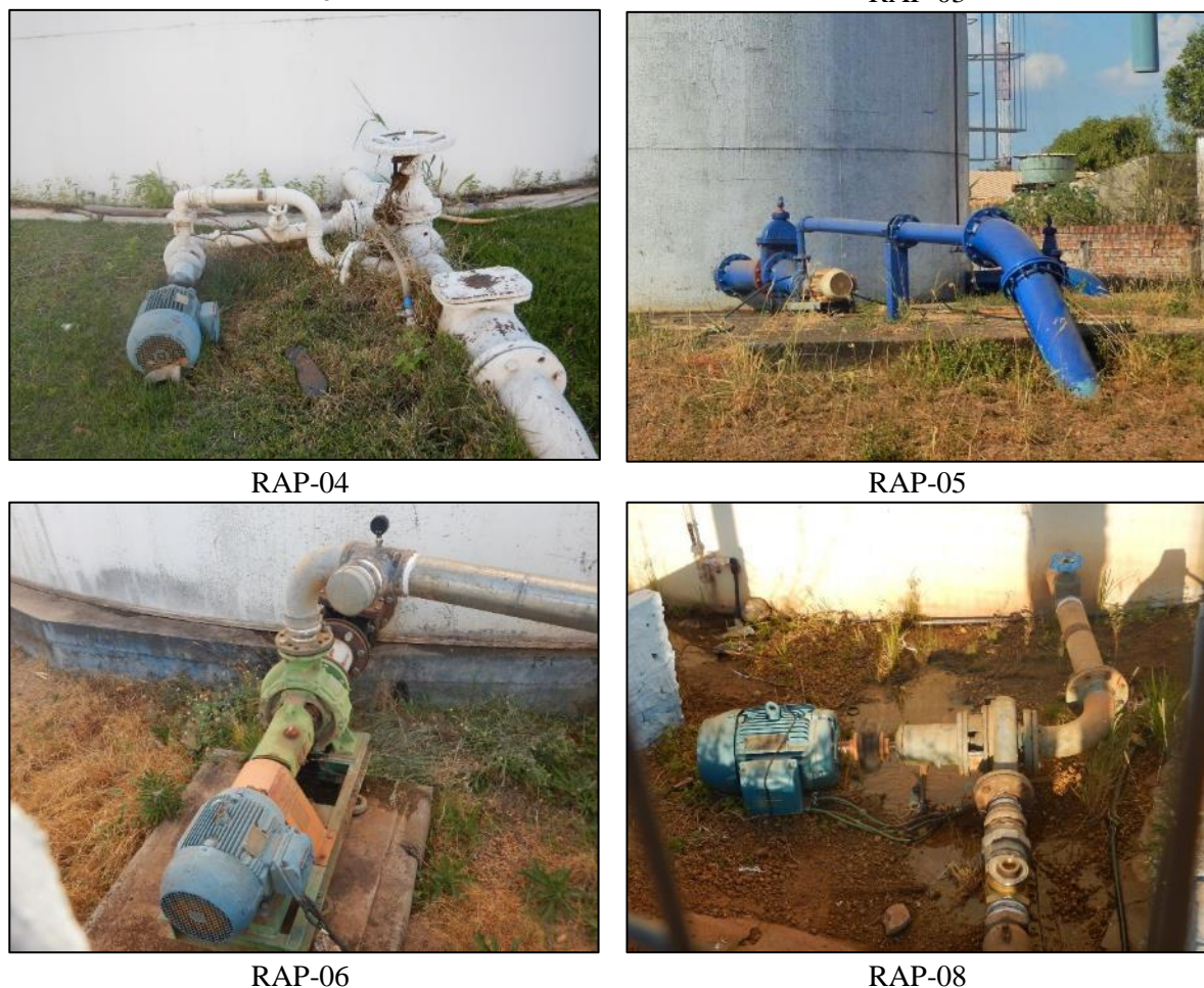
Figura 20. Estações pressurizadoras dos reservatórios do SAA de Lucas do Rio Verde
