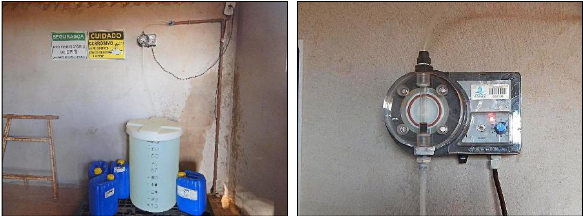
Figura 15. Sistema de desinfecção e bomba dosadora eletromagnética utilizada nos poços do SAA de Lucas do Rio Verde: PT-30
