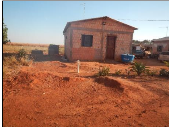
Figura 81. Vista exterior de fossa negra implantada na comunidade
