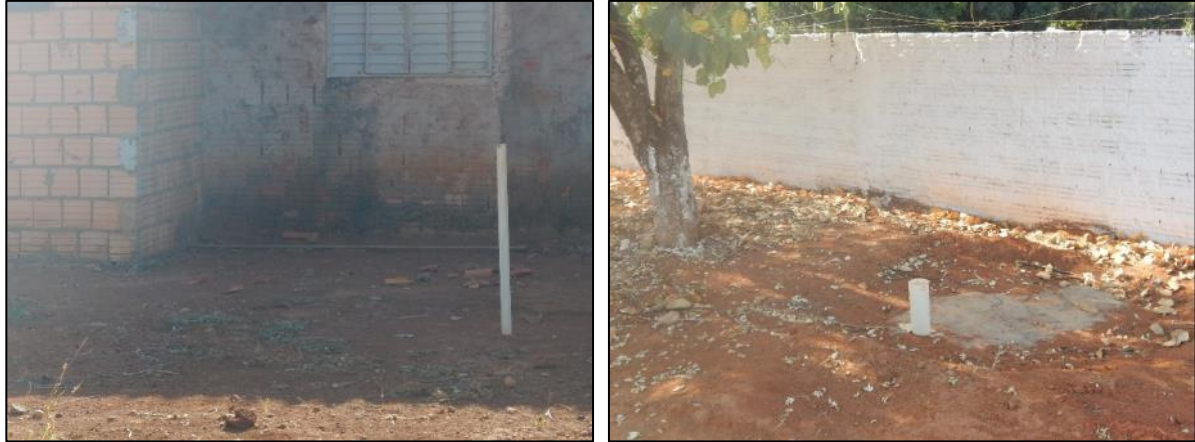
Figura 73. Vista exterior de fossas negras implantadas no distrito
