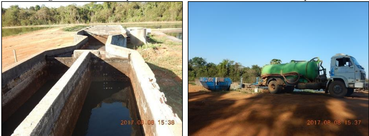
Figura 29. Tratamento preliminar recebendo efluentes de caminhões limpa-fossa
