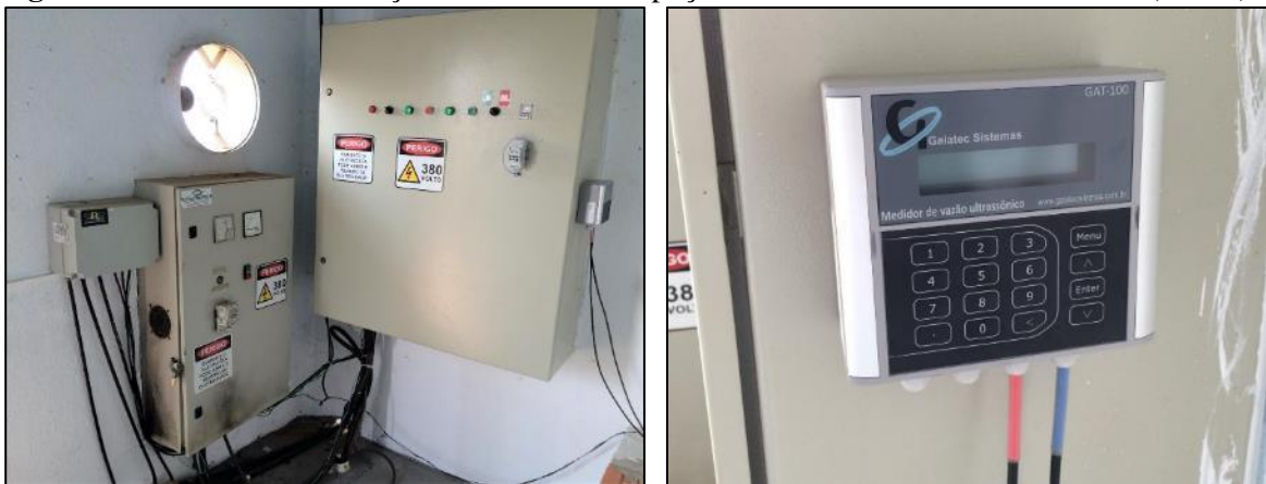
Figura 13. Sistema de automação e telemetria dos poços do SAA de Lucas do Rio Verde (PT-13)
