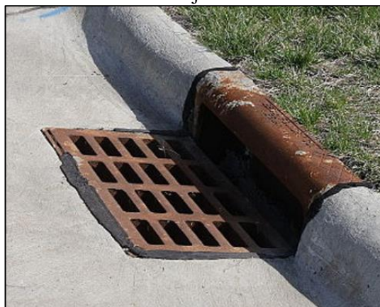
Figura 20. Boca de lobo com gradeamento na sarjeta
